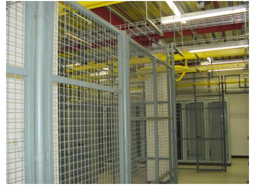
Vista parcial del sistema de cableado.
