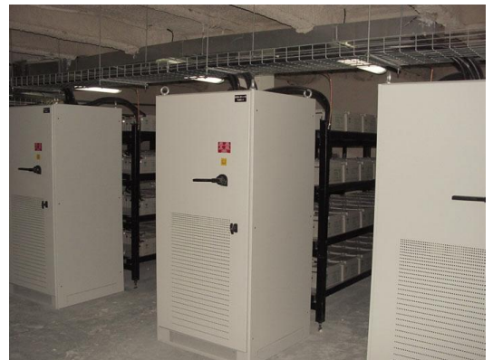
Sala de Baterías y SAIs. Toda esta infraestructura está montada de manera redundante
